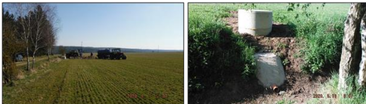
Obr. 24 Šachtice 1-1 – čištění svodného drénu v délce 113 m pomocí hydročističe (vlevo), kompletní vystrojení šachtice s vyústěním do HOZ (vpravo)
