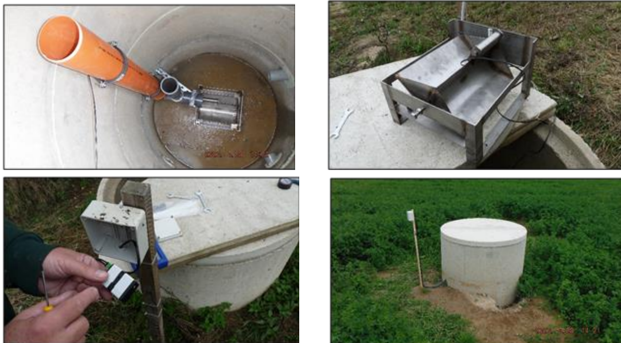
Obr. 36 Do šachtic drenážní skupiny 1 a 14 byly umístěny regulační prvky a objemové průtokoměry typu tipping-bucket (na dvou obrázcích nahoře). Měření je dále doplněno o průtokoměry rychlostní, v provedení axiálních vrtulek zabudovaných do PVC KG100 (dva obrázky dole) – s osou vertikálně orientovanou (na přepadovém potrubí RP) a horizontálně orientovanou (pro odvodňovací fázi).
