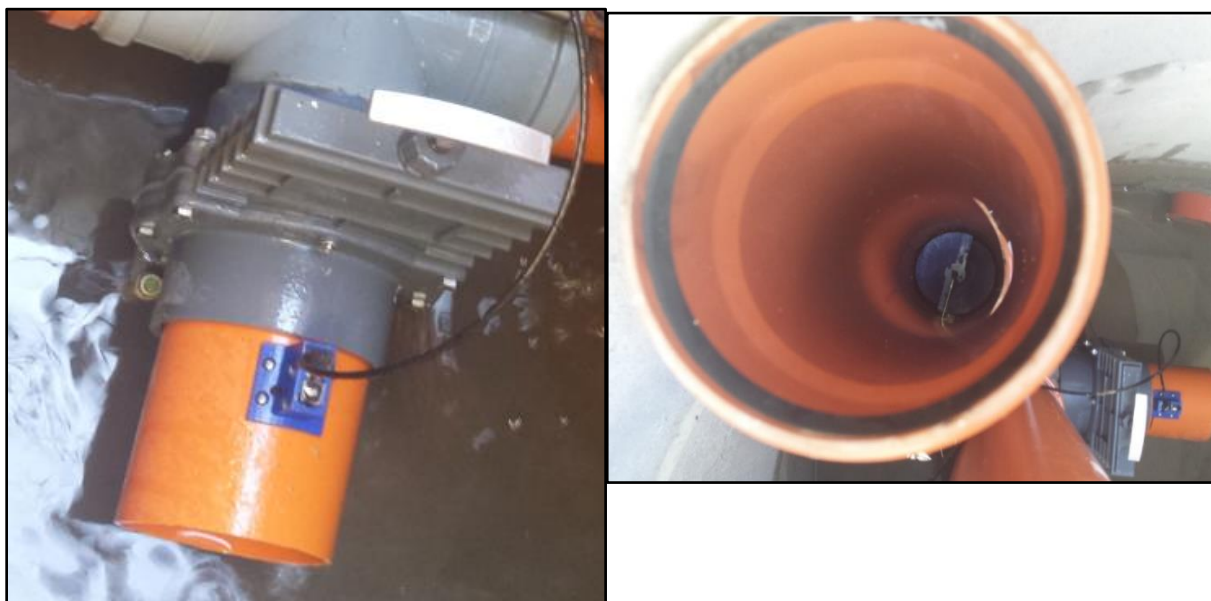
Obr. 37 U šachtic byly instalovány offline datalogery (s přípravou napojení na monitorovací síť)
